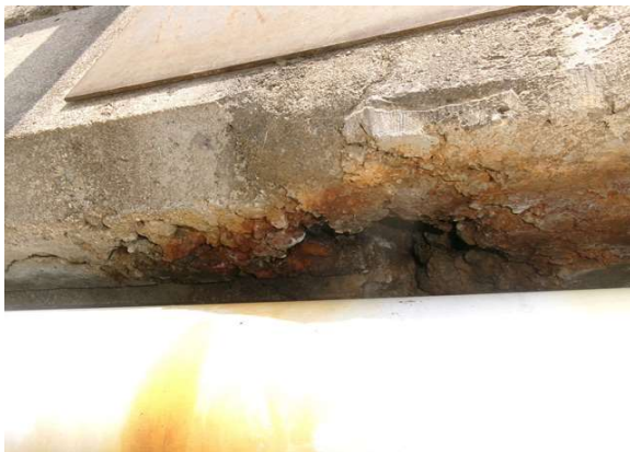
S4 바닥판하면 파손 및 철근노출
