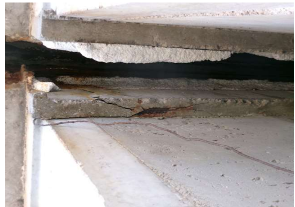
S6 바닥판하면 파손 및 철근노출
